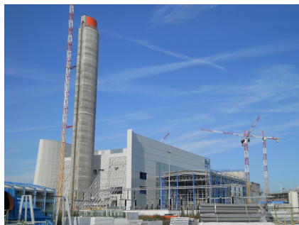
TRM Spa – Nuovo Termovalorizzatore del Gerbido (TO)
